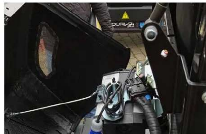
Batteriutrymme med litium/jon-batterier innanför huven; allt här har monterats som en byggsats av tyska materialhanteringsföretaget Jungheinrich.
